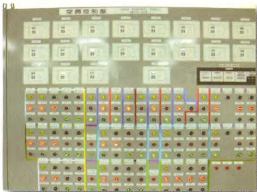
圖4.核二廠廢棄物貯存庫5樓操作室內的空調系統控制面板
