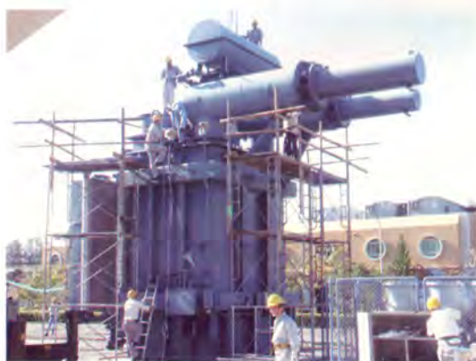
圖2. 核三廠主變壓器檢修
