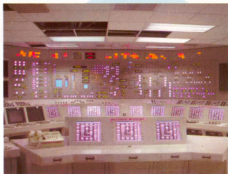
圖5.1號機主控制室一景
