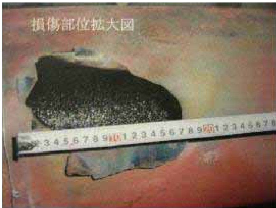
圖 4 相馬共同火力新地電廠 2 號機管路破洞
