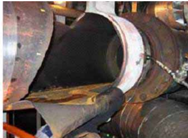
圖 3 美濱 3 號機冷凝水管路破斷處照片
