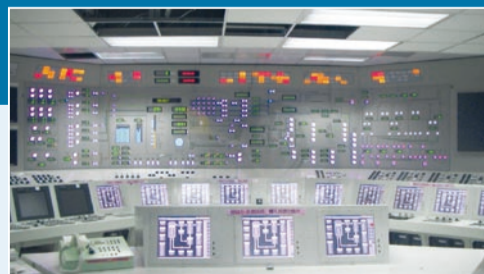
核能四廠1號機主控室一景
