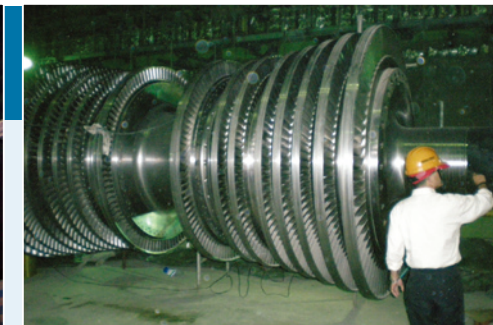
1號機高壓汽機轉子維護保養作業
