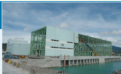
核能四廠循環水抽水機房
