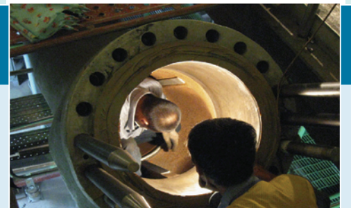
核能四廠主蒸汽隔離閥銹蝕清理
