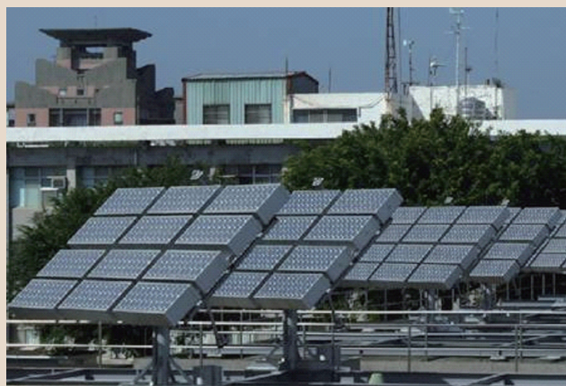
✧ 屋頂式1.5 kW HCPV系統
